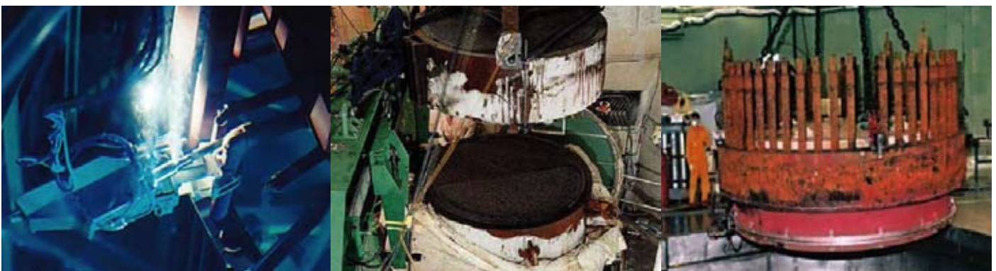
Smantellamento del recipiente a pressione del reattore per mezzo di taglio ad arco del metallo
